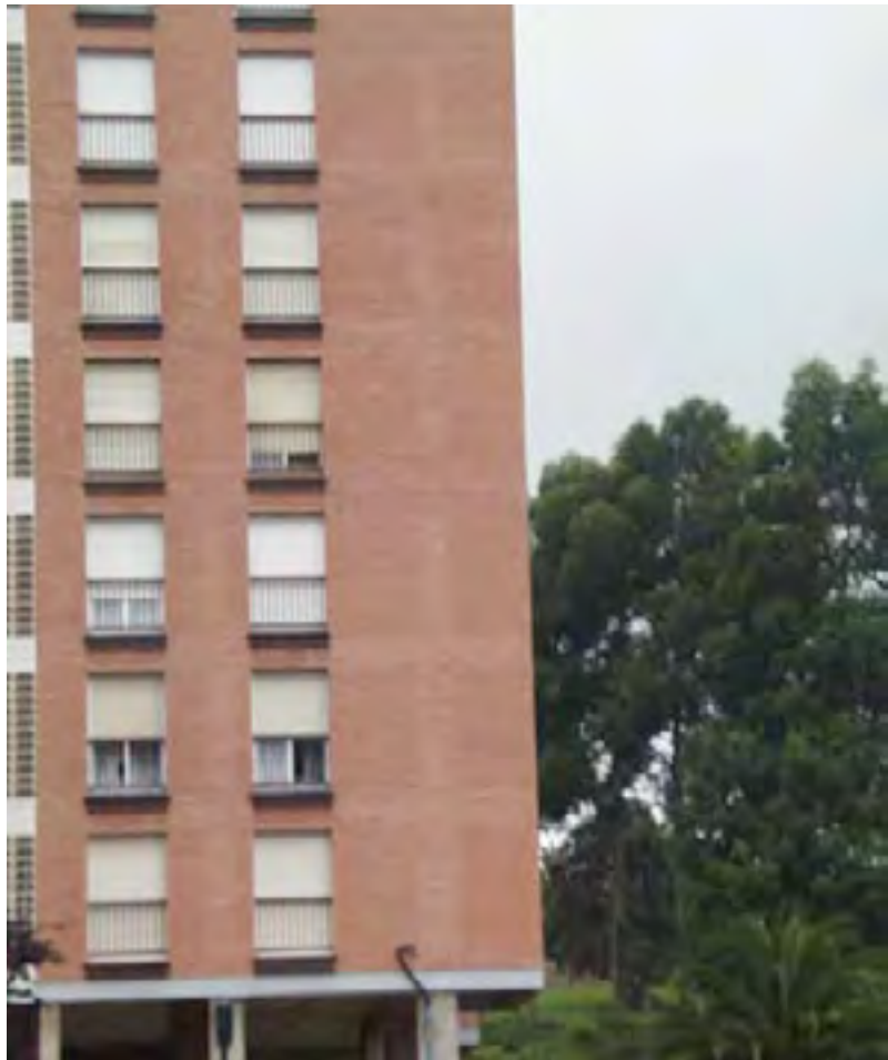
Imagen edificio con puentes térmicos marcados
